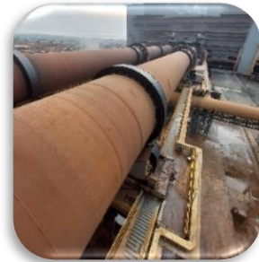
Proses Kalsinasi di rotary kiln
