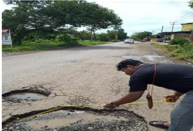
Pengukuran Luas Kerusakan Jalan
