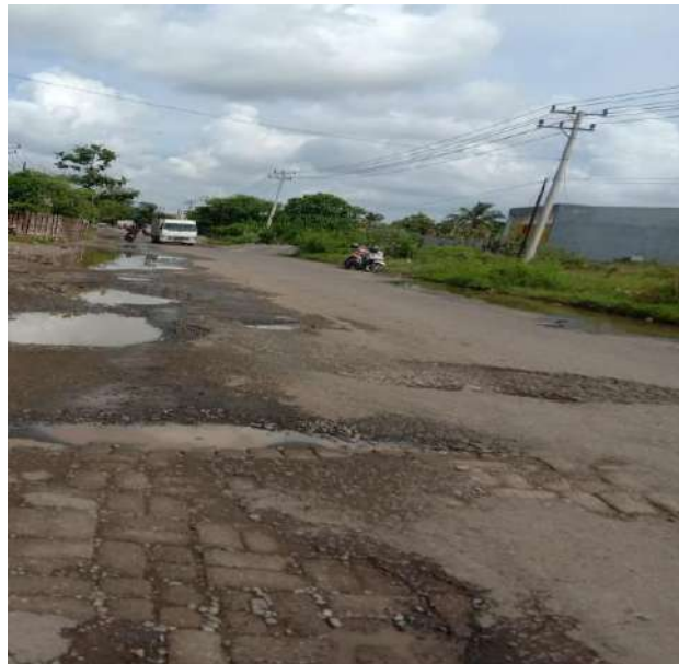
Kondisi Perkerasan Jalan
