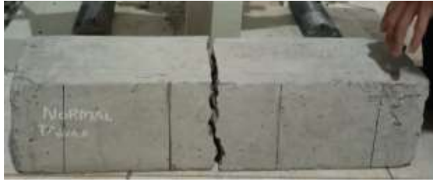
Gambar IV. 11 Pola Retak Benda Uji Balok Beton Normal 3
