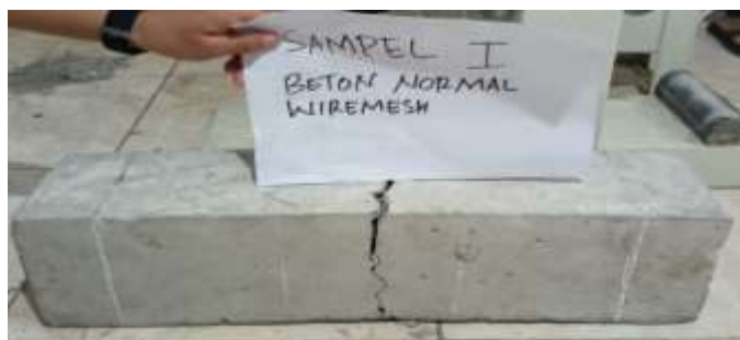
Gambar IV. 13 Pola Retak Benda Uji Balok Beton Normal Wiremesh 1
